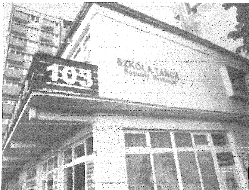
Fot. 9. Płyta wspornika w bocznej elewacji budynku stanowiąca przedłużenie płyty tarasu.
