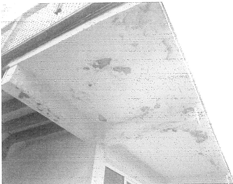
Fot. 1. Ubytki tynku na dolnej płaszczyźnie płyty tarasu.
