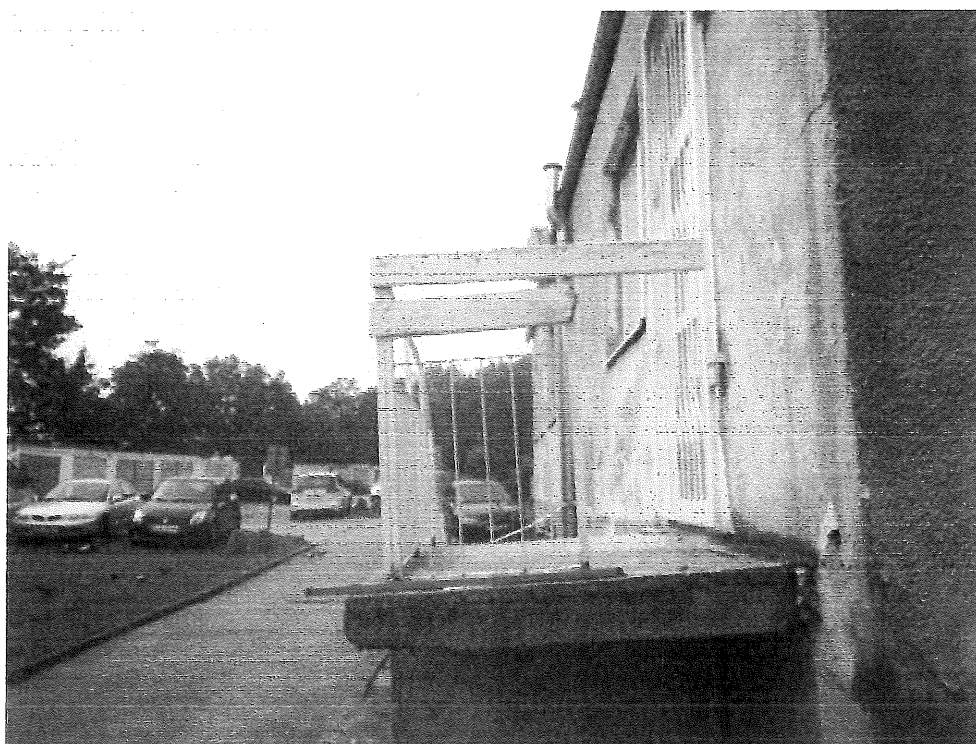
Fot. 2. Widoczne pochylenie płaszczyzny podestu jest wynikiem osiadania ściany fundamentowej konstrukcji schodów. Zniszczona balustrada stalowa podestu tymczasowo zabezpieczona deskami drewnianymi.
